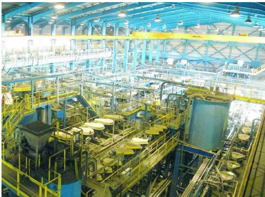
FIGURA 2.12 | Planta de tratamiento de MATSA
