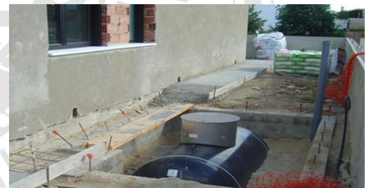
Tanque soterrado GLP. Detalle protección catódica
