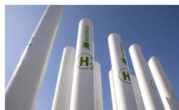
Instalación de hidrógeno verde de Iberdrola
